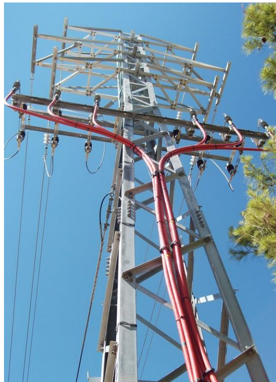
Fig. 6 Torre de alta tensión con conexión a línea soterrada.
